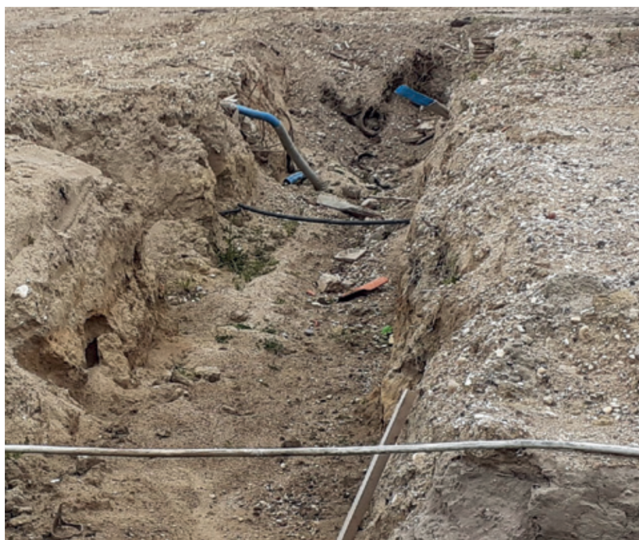
Underlag på byggeplads, med asbestfragtmenter kørt ned i jorden.
