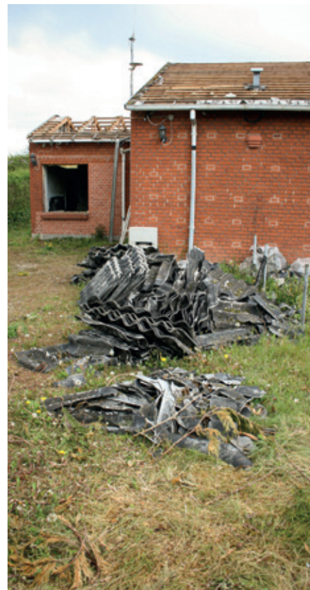
Asbestplader er smidt ned fra taget og samlet i en bunke. Der er spredt asbest på selve grunden, men også på loftet af den blivende bygning.
