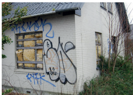
Kondemneret hus malet med blyholdig malmaling. Før nedrivning skal malingen renses af og opsamles for korrekt bortskaffelse.
