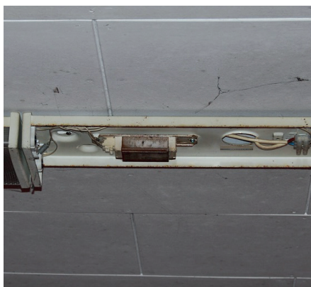
Ældre armaturer til lysstofrør indeholder ofte PCB.
