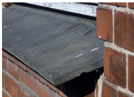
Sålbænk – kan indeholde asbest. Hvis der er usikkerhed om indholdet af asbest, skal materialerne håndteres, som om de indeholder asbest. Ved større mængder skal der foretages analyse.
