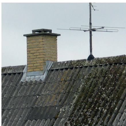
Ældre eternittage indeholder som oftest asbest.
