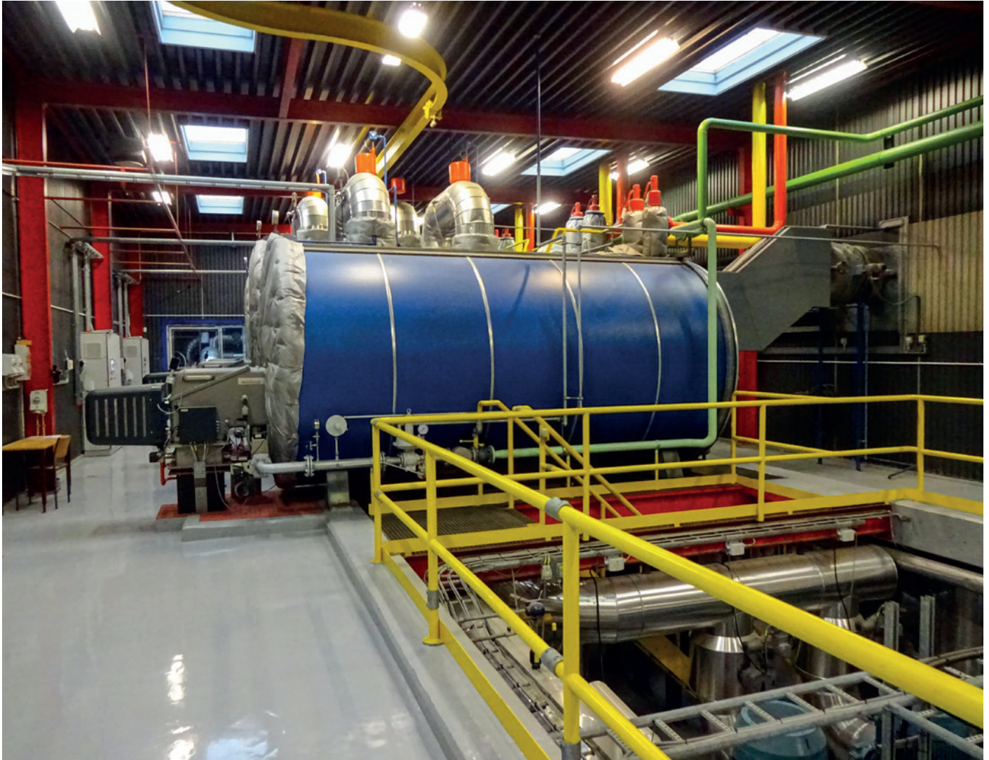
Tilsyn på fjernvarmecentralen.
