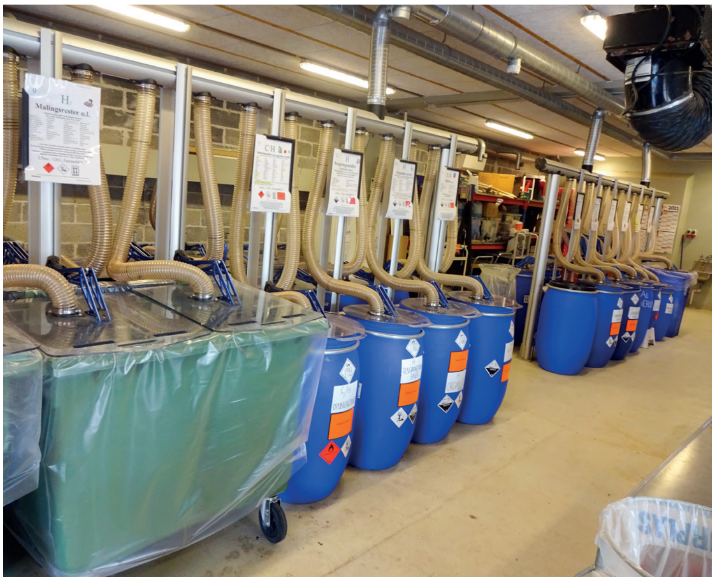
Det nye udsugningssystem til det farlige affald på Genbrugsstationen.
