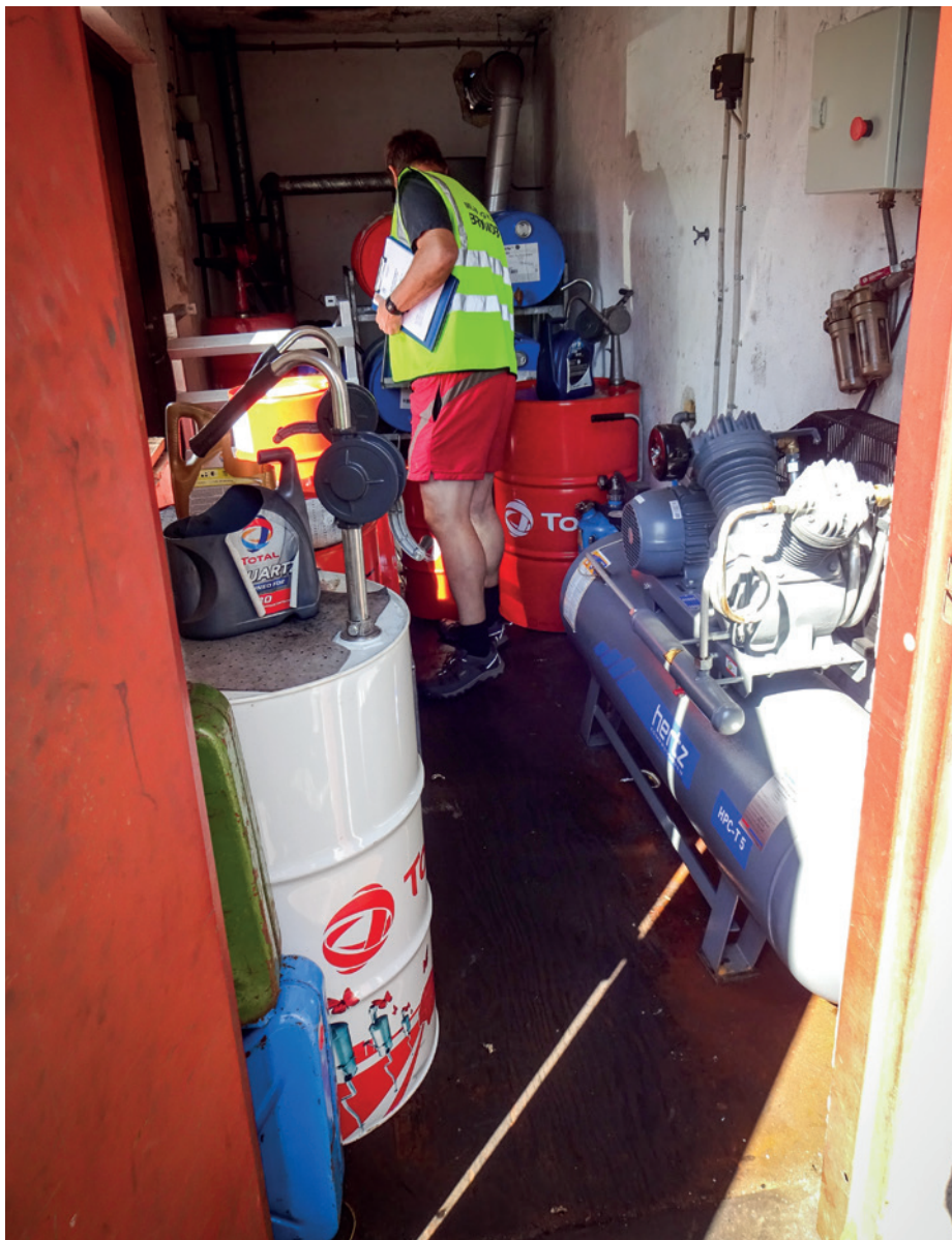
Miljøtilsyn i kompressorrum med oplag af farlige råvarer.
