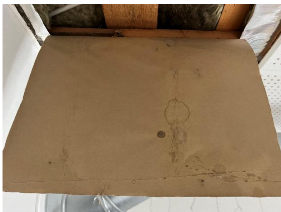
Billede 30, viser tidligere vandindtrængning i loft.
