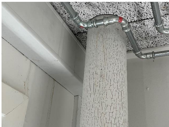
Billede 6, viser tegn på vandindtrængning ved loft.
