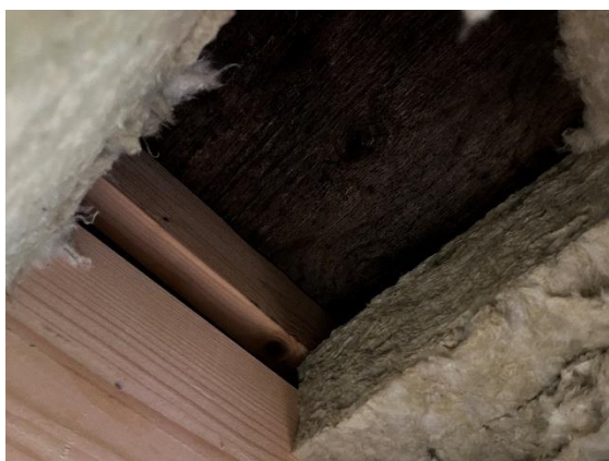
Billede 4, viser isolering og hulrum i loftkonstruktion og skimmelsvampevækst på underside tagkrydsfiner.
