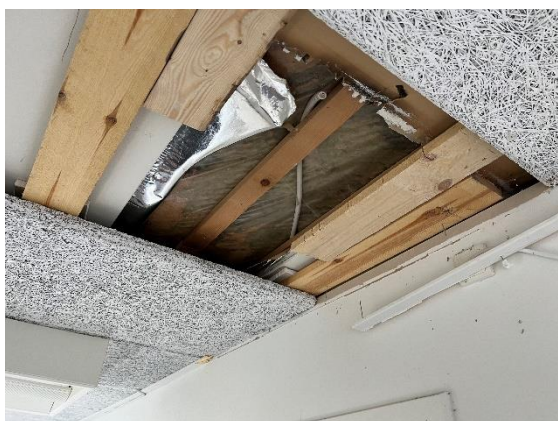
Billede 3, viser loft i flere lag og reparationer på dampspærre.
